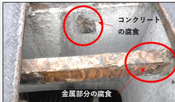
写真4 硫黄泉流入浄化槽の腐食状況
